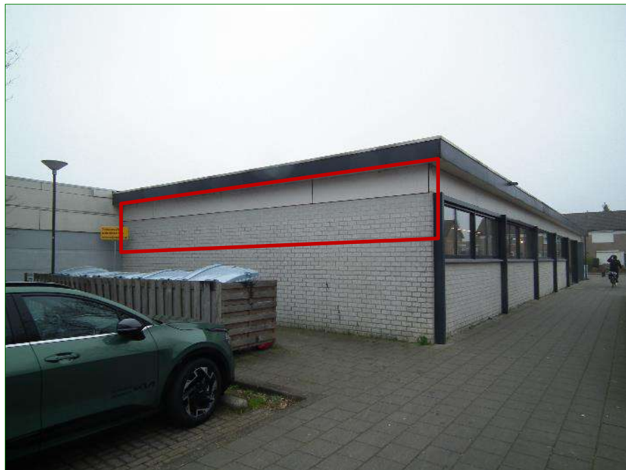
Foto's van gebouwdelen met potentie voor vleermuizen (zie rode omlijning). Boven: muur aan noordzijde met open stootvogen en dakrand met kieren. Onder: muur aan zuidzijde met open stootvoegen en dakrand met kieren.
