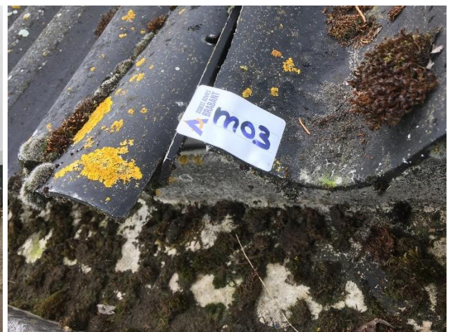
Foto 6 | Foto voor bron Golfplaat afdak achter loods 1
