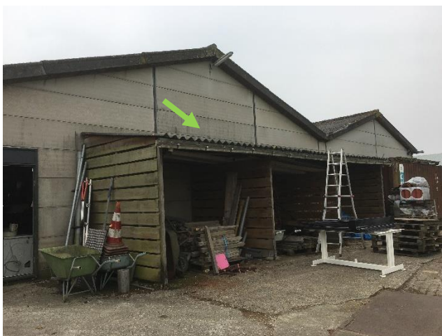
Foto 5 | Foto voor bron Golfplaat afdak achter loods 1
