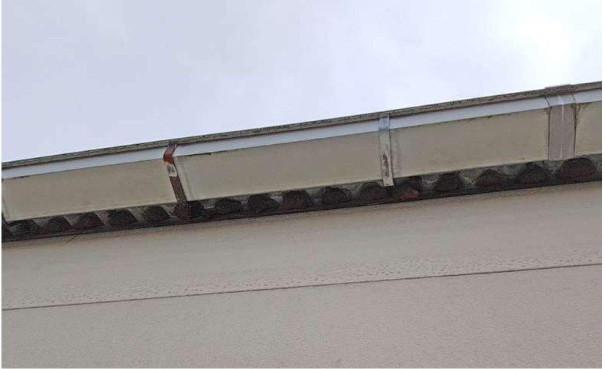
Afbeelding 3: Openingen tussen gevel en dakbedekking zijn dichtgemaakt met purschuim.
