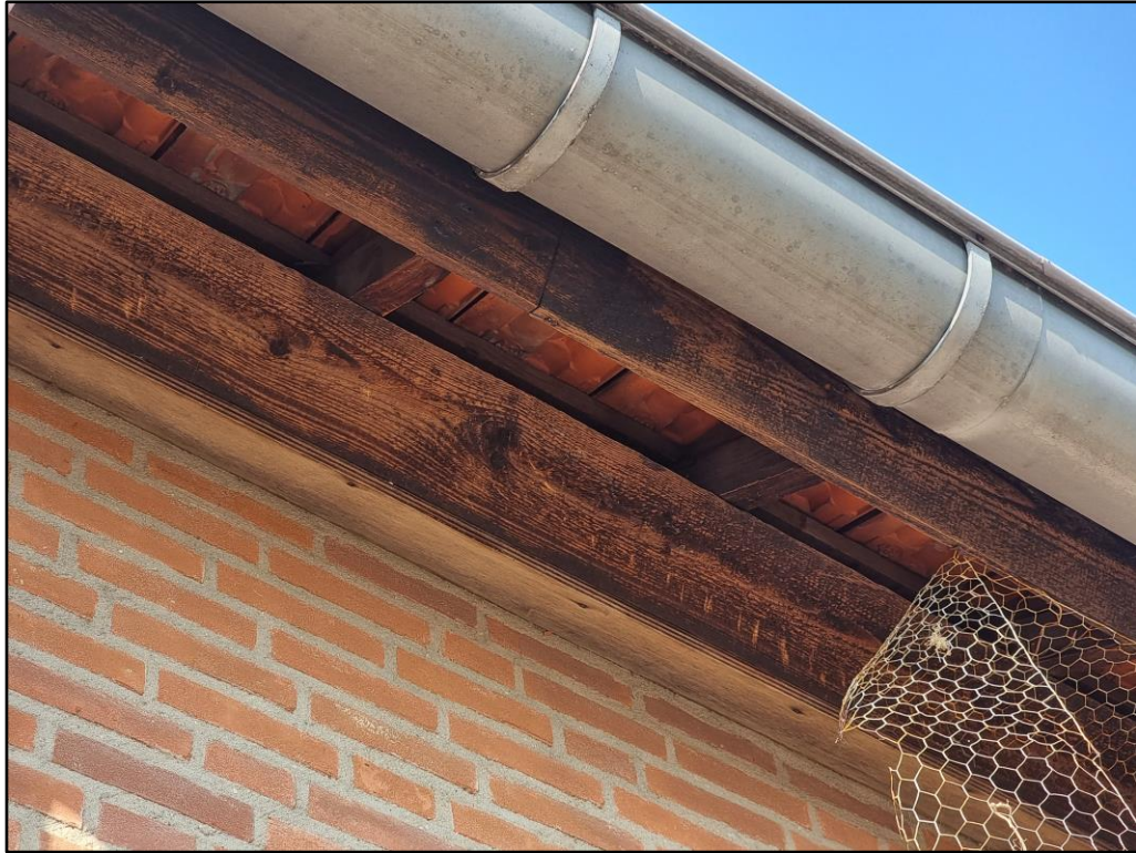
Figuur 5 Aanwezige openingen onder de dakrand van de bebouwing waar gierzwaluwen toegang kunnen krijgen tot mogelijke nestlocaties.
