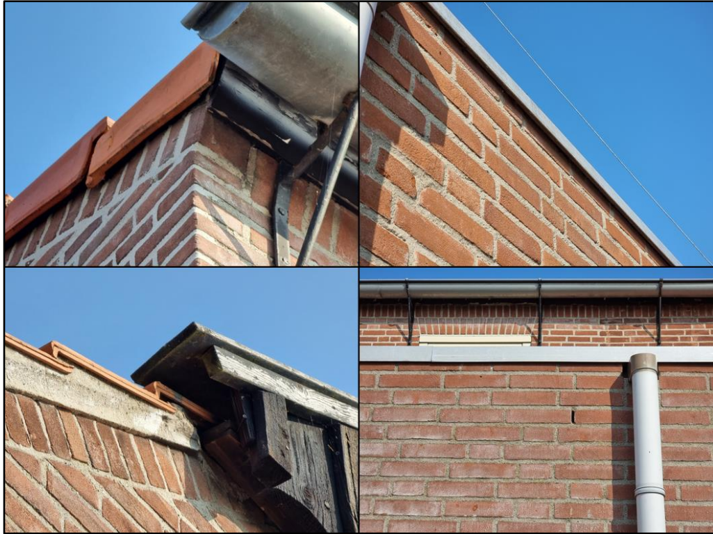
Figuur 4 Aanwezige openingen welke mogelijk toegang bieden tot achterliggende ruimtes in de vorm van open stootvoegen, kierende kantpannen en daklijsten en ruimte onder goot en/of gevelbeplating.
