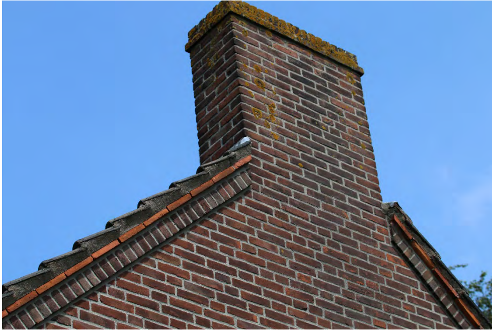
Figuur 17. De nokpannen zijn dichtgesmeerd met cement.
