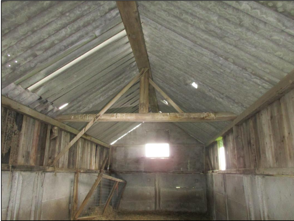
Figuur 1 De binnenzijde van de schapenstal, op de balk zijn uitwerpselen van duiven aanwezig.
