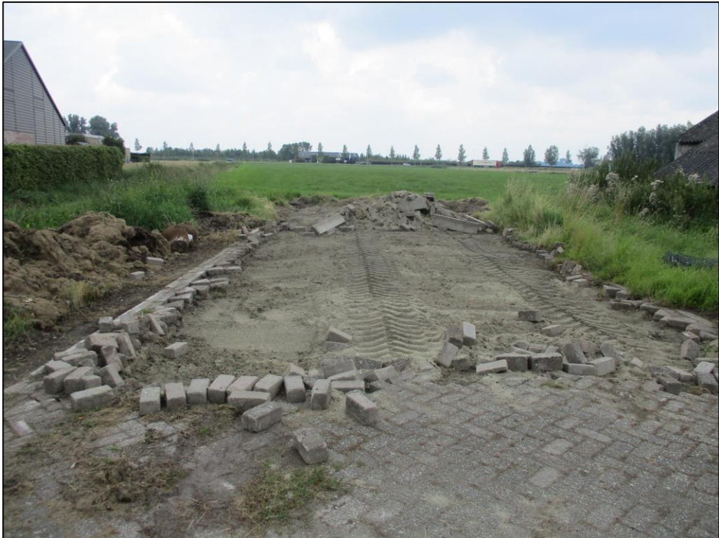
Figuur 4 Delen van de klinkers zijn reeds verwijderd.
