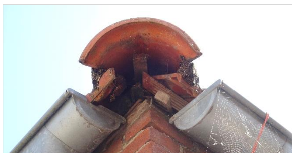
Figuur 5.1 Voorbeeld (1) van een opening die toegang verleent tot ruimte onder het dak.
