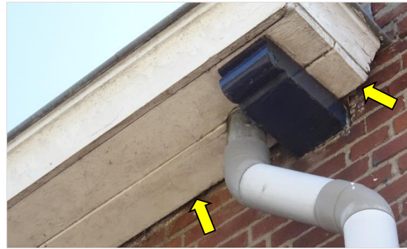
Figuur 5.7 Ruimte achter dakgoot betreffend woonhuis.
