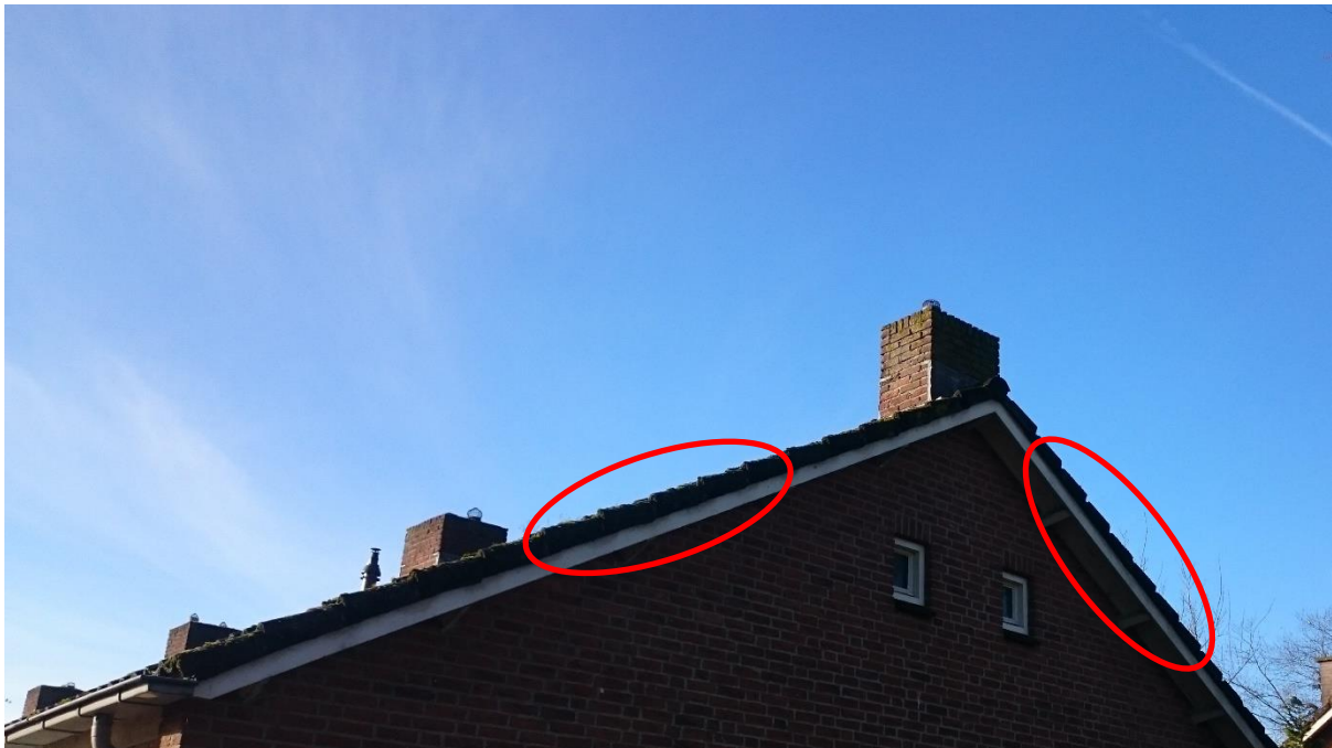
Foto 3. Overhangende dakpannen die kunnen fungeren als opening naar verblijfplaatsen van vleermuizen.
