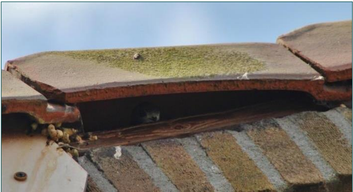
Figuur 2.3 Kierende kantpannen en ruimtes tussen de dakgoot en gevel bieden vaak de mogelijkheid tot nestlocaties voor gierzwaluwen (bron: Gert de Jong).
