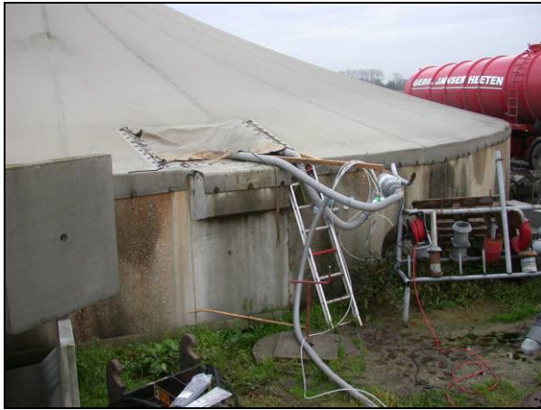
Meting mestsilo, ventilator met injectie en monsternameleidingen
