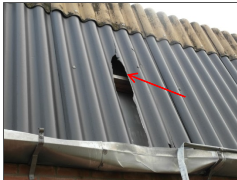
Figuur 22: door vrachtwagen kapotgereden zijkant gebouw
